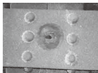
写真3 座金の下地状態
